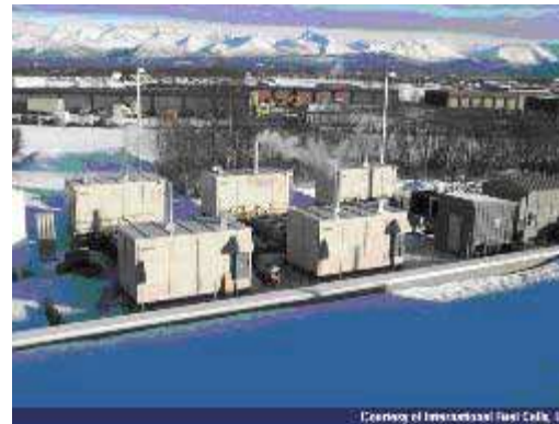
Пять 200 кВт топливных ячеек на Аляске [Bellona web site]
