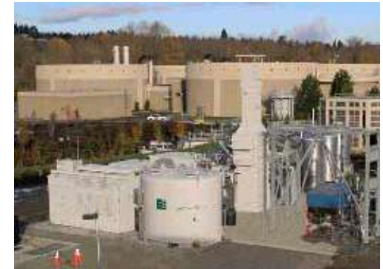
1-MВт система топливных ячеек [Fuelcell Energy Inc. web site]
